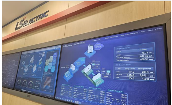
LSE 베트남 박닌 공장 ESS 관제센터
