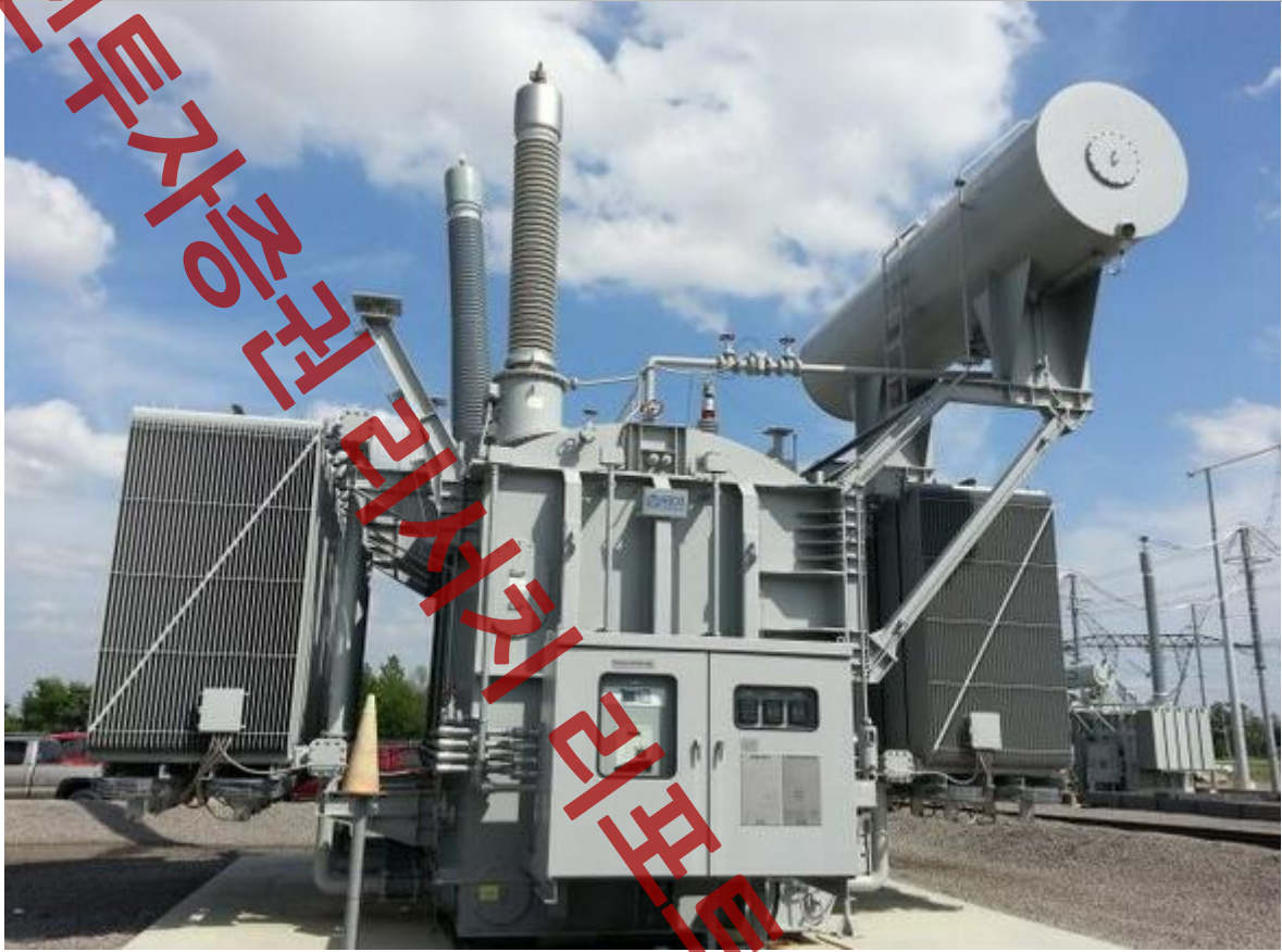
도표 129. 미국 송전망에 설치된 효성중공업의 765kV 초고압 변압기
