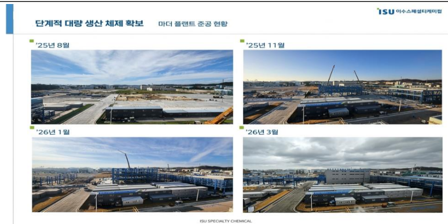
그림 9. 이수스페셜티케미컬 황화리튬 마더 플랜트 준공 현황
