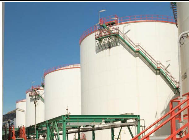
그림17. ILBOC 윤활기유 수출터미널 및 저장탱크(2)
